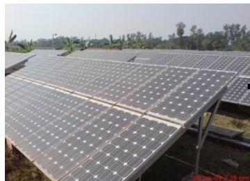
SOLAR PV ARRAY (25 kWp)
